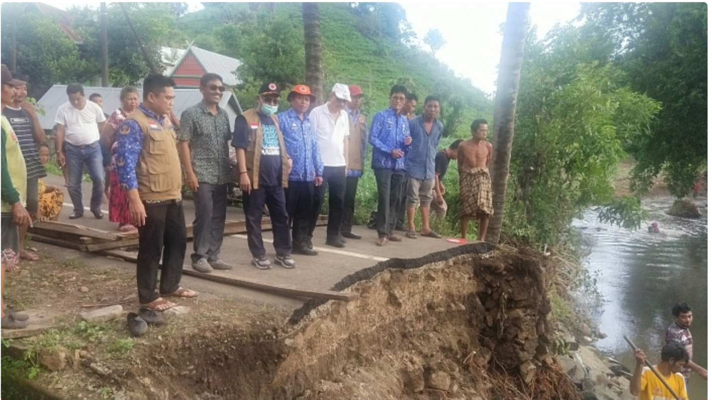
Plt. Kadis PUPR Muh Jafar Abbas dan Kadis BPBD Jeneponto, Ikrar Ishak Iskandar Pantau Kondisi Jembatan Runtuh di Desa Bulusuka
